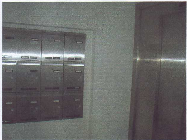
Poštovní schránky, výtah
